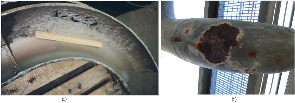
Рис. 1. Дефекти відводів трубопроводів: а) – ерозія; б) – корозія.
